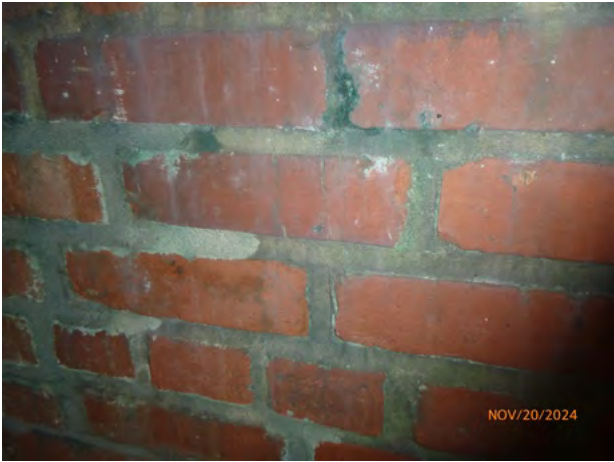
866-143 Brick_Crack Single unit 2024-2.jpg
