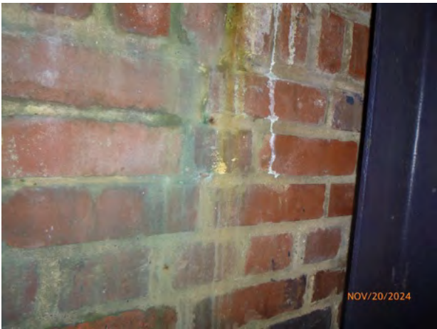
857-140 Brick_SoilStain Rust 2024-2.jpg
