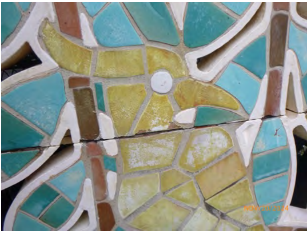
111-169 TerraCotta_SurfLoss Glaze loss 2024-1.jpg
