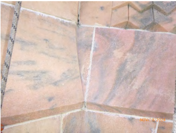
35-184 Stone_SurfLoss Chipped 2024-2.jpg
