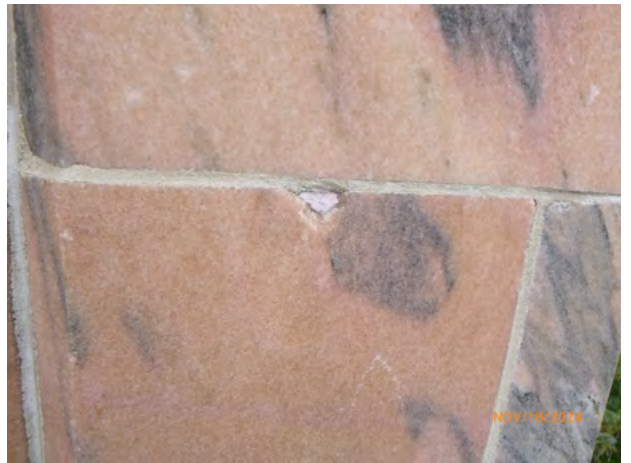
356-187 Stone_SurfLoss Chipped 2024-1.jpg
