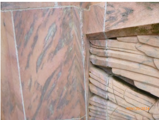
133-139 Stone_SurfLoss Chipped 2024-2.jpg
