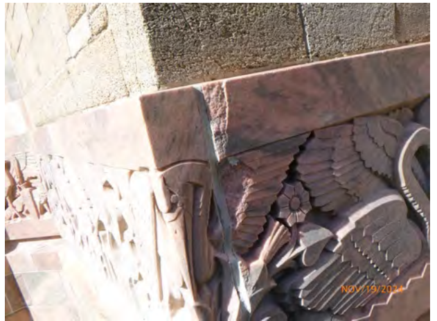
335-30 Stone_SurfLoss Chipped 2024-1.jpg
