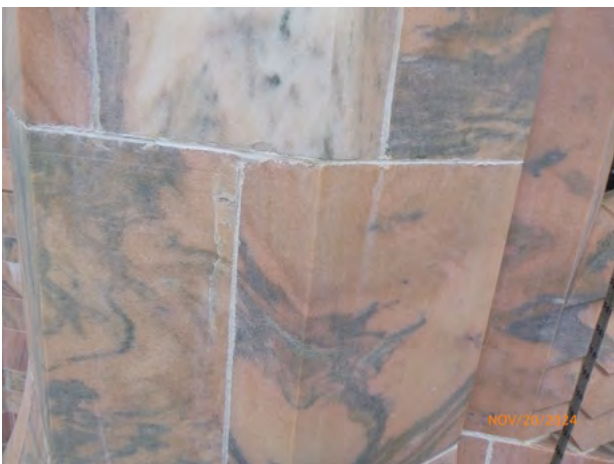
134-187 Stone_SurfLoss Chipped 2024-2.jpg
