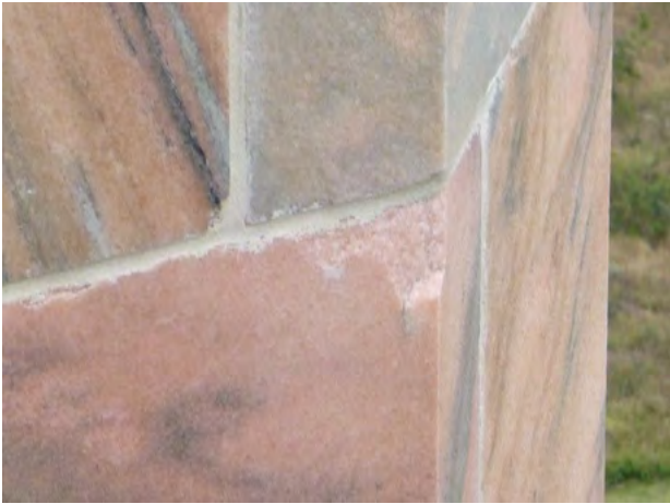
156-188 Stone_SurfLoss Chipped 2024-1.jpg
