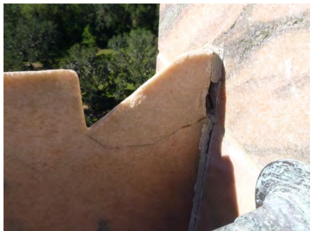
640-198 Stone_Crack Single unit 2024-1.jpg
