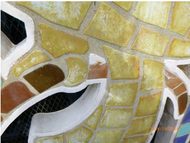
218-161 TerraCotta_SurfLoss Glaze loss 2024-1.jpg
