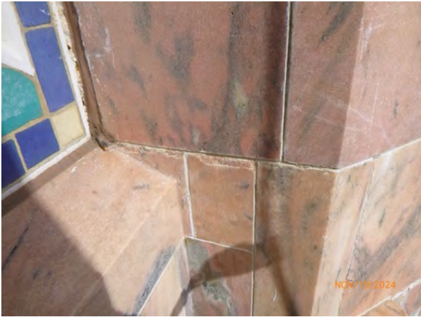
341-143 Stone_SurfLoss Chipped 2024-1.jpg
