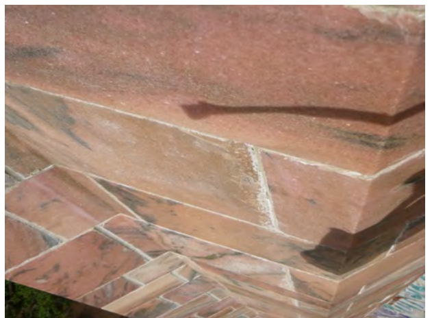
234-180 Stone_SurfLoss Chipped 2024-2.jpg
