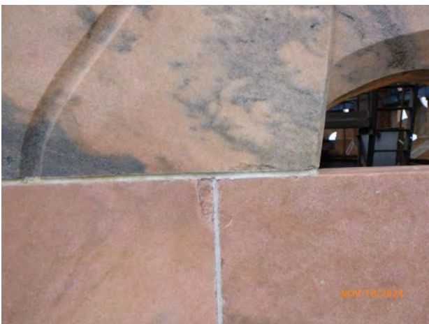
352-184 Stone_SurfLoss Chipped 2024-2.jpg
