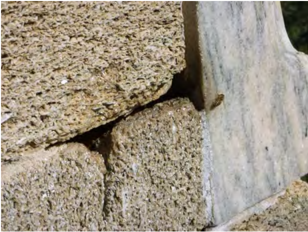
266-92 Stone_Joints Mortar Missing 2024-1.jpg
