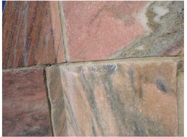
334-182 Stone_SurfLoss Chipped 2024-2.jpg
