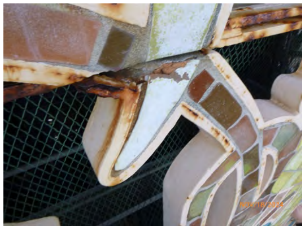
13-173 TerraCotta_Spall Missing 2024-2.jpg
