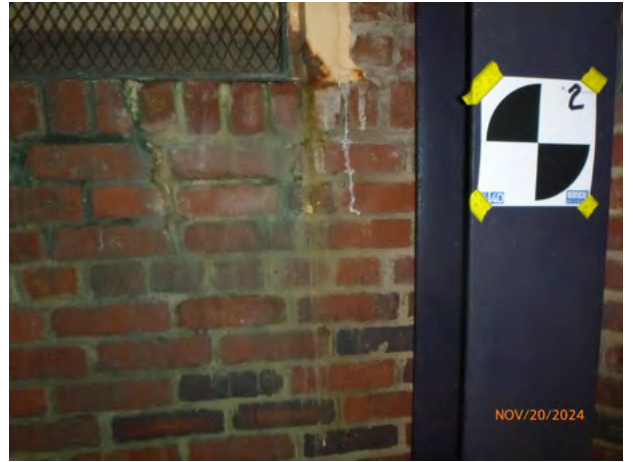
857-140 Brick_SoilStain Rust 2024-1.jpg
