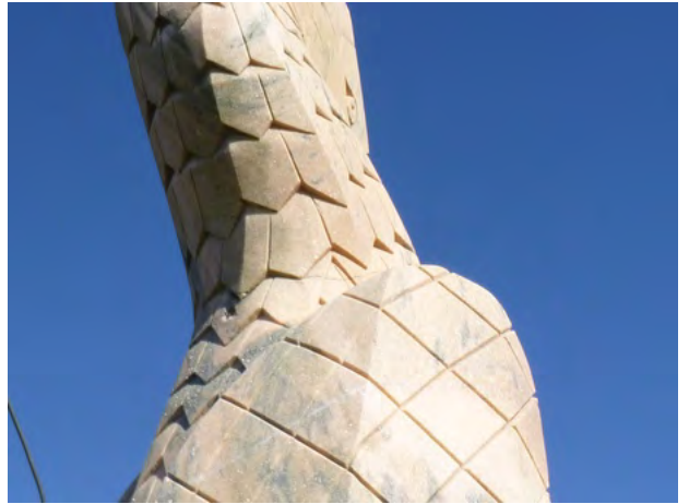
844-205 Stone_Crack Single unit 2024-1.jpg
