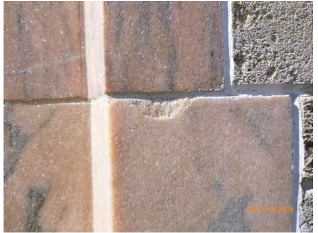
335-107 Stone_SurfLoss Chipped 2024-1.jpg
