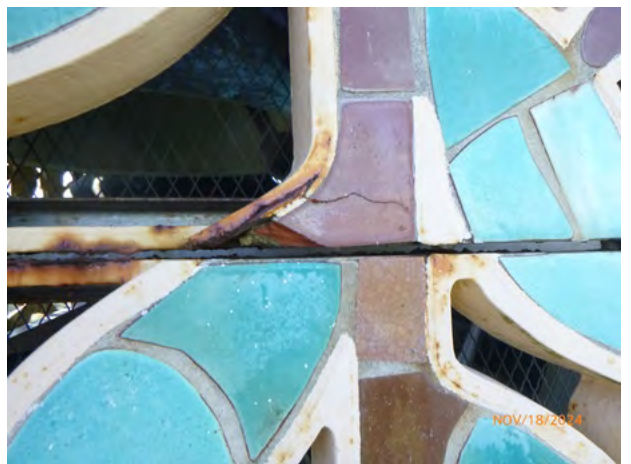
10-154 TerraCotta_Spall Missing 2024-1.jpg
