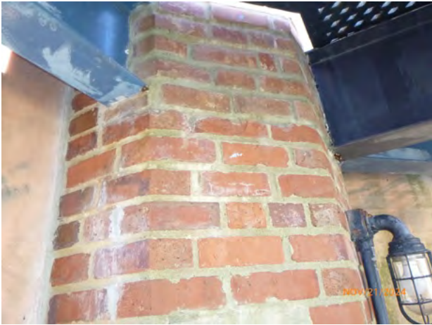
756-191 Brick_SurfLoss Face spalled 2024-1.jpg
