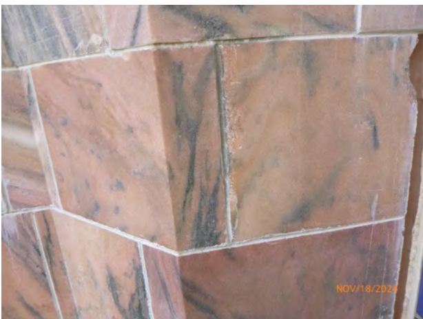
345-171 Stone_SurfLoss Chipped 2024-2.jpg
