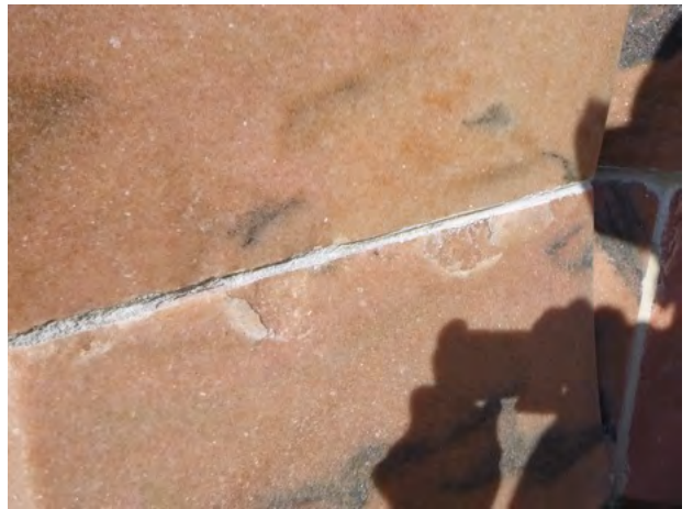
334-184 Stone_SurfLoss Chipped 2024-1.jpg
