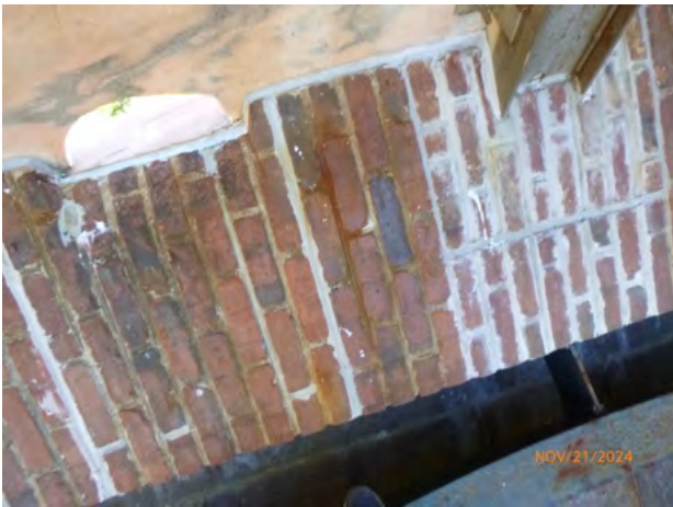
851-184 Brick_SoilStain Rust 2024-1.jpg
