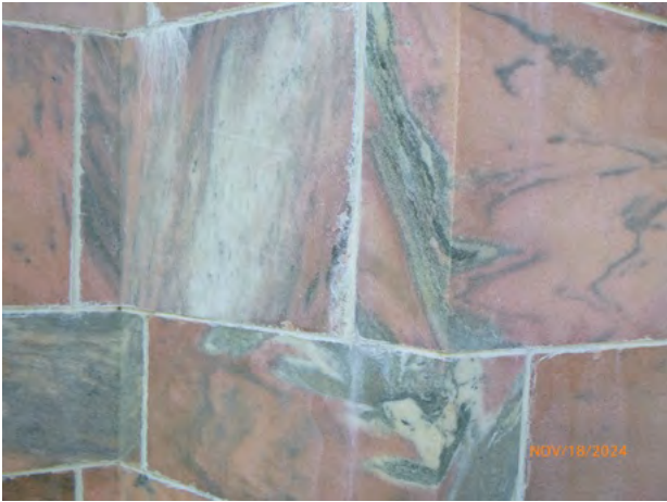
35-164 Stone_SurfLoss Chipped 2024-2.jpg
