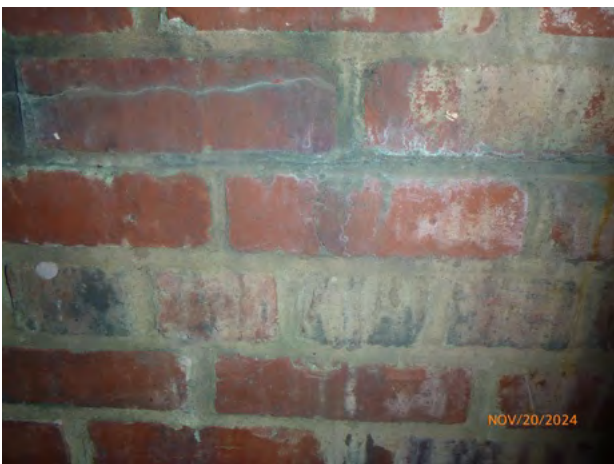
650-142 Brick_Crack Single unit 2024-2.jpg
