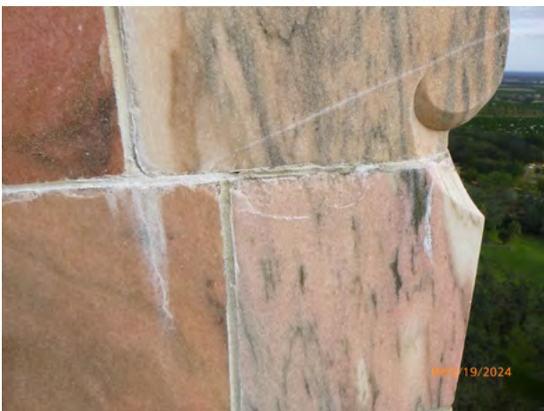
172-158 Stone_SurfLoss Chipped 2024-1.jpg
