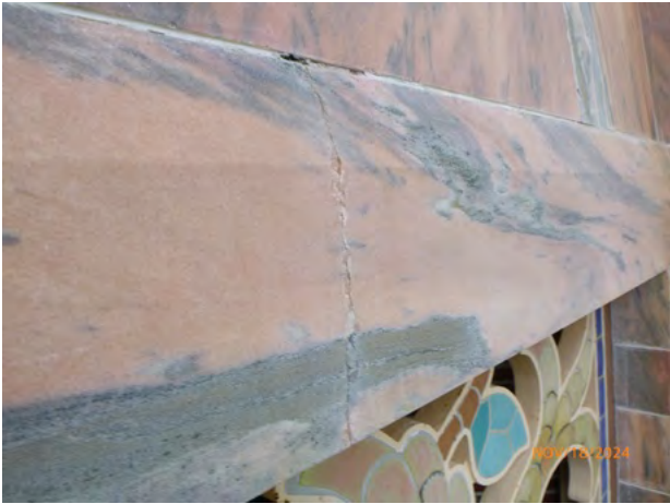
351-138 Stone_Crack Single unit 2024-3.jpg
