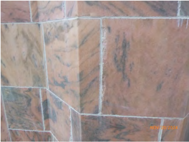
133-159 Stone_SurfLoss Chipped 2024-1.jpg
