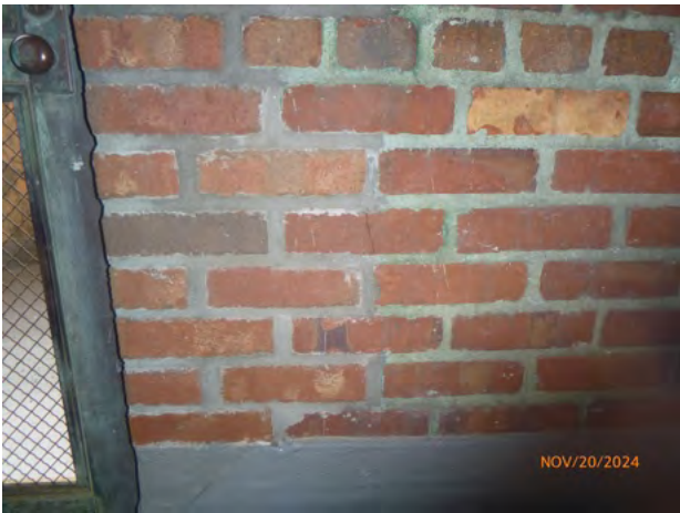
640-139 Brick_Crack Single unit 2024-1.jpg
