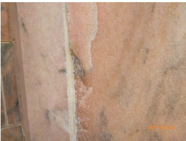
167-142 Stone_SurfLoss Chipped 2024-2.jpg
