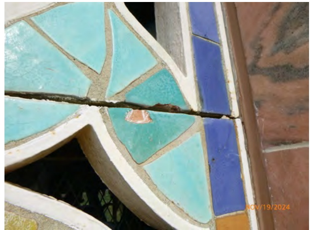
218-163 TerraCotta_SurfLoss Glaze loss 2024-1.jpg
