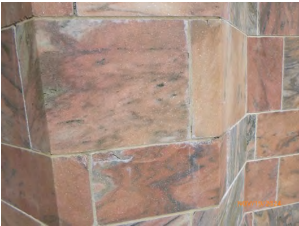
341-150 Stone_SurfLoss Chipped 2024-1.jpg
