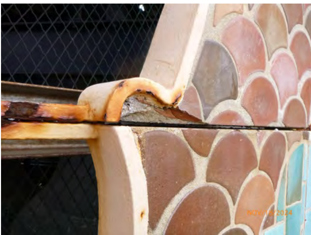
385-159 TerraCotta_Spall Missing 2024-2.jpg
