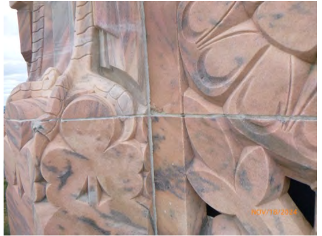
345-194 Stone_SurfLoss Chipped 2024-1.jpg
