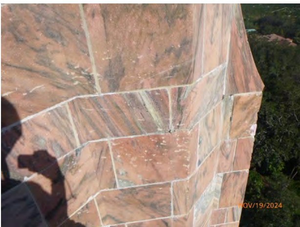
341-181 Stone_SurfLoss Chipped 2024-2.jpg
