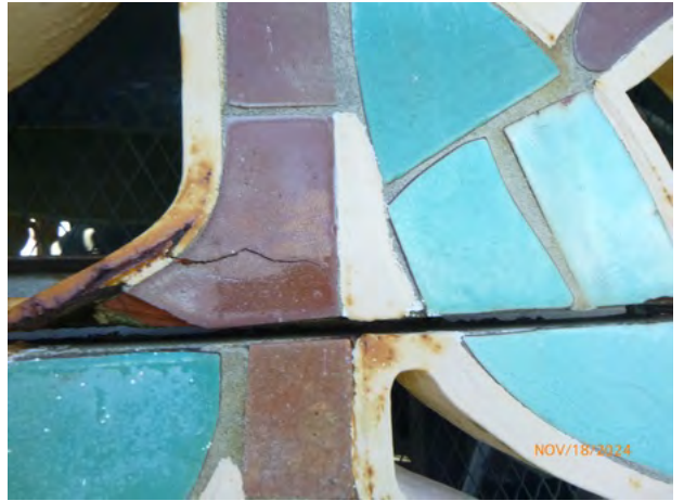
10-155 TerraCotta_Crack Single unit 2024-1.jpg
