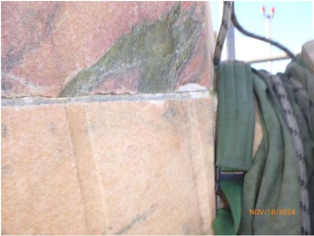
35-195 Stone_SurfLoss Chipped 2024-1.jpg
