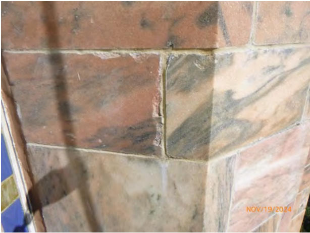
324-157 Stone_SurfLoss Chipped 2024-1.jpg
