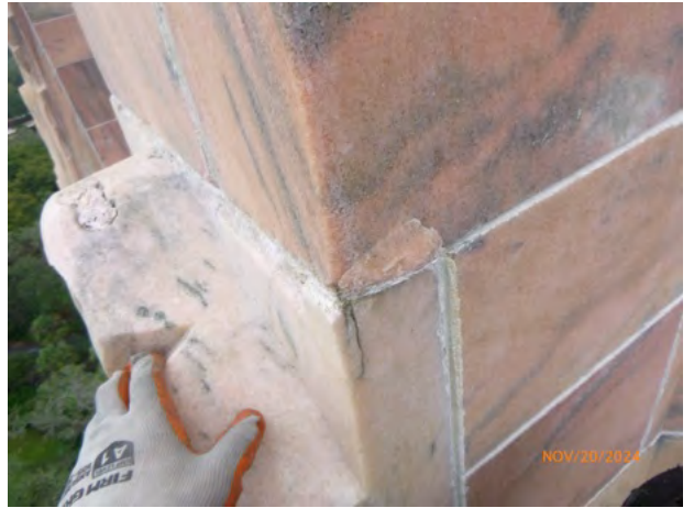
131-162 Stone_SurfLoss Chipped 2024-2.jpg
