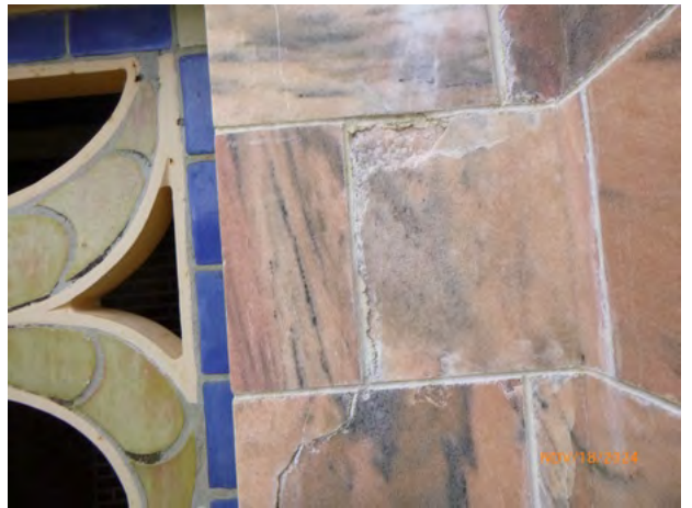
356-137 Stone_SurfLoss Chipped 2024-2.jpg
