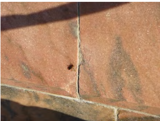
248-184 Stone_SurfLoss Chipped 2024-1.jpg
