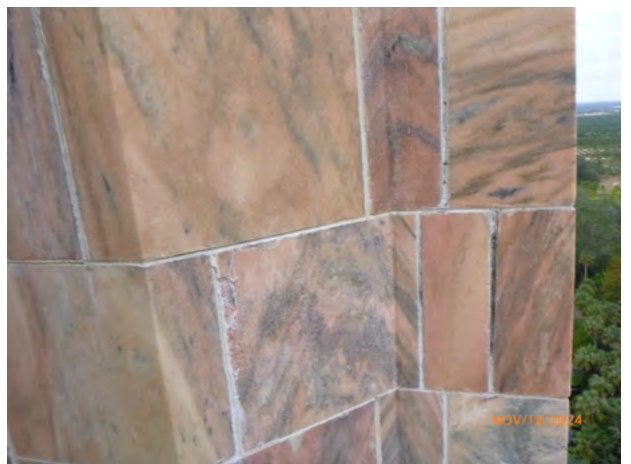
356-174 Stone_SurfLoss Chipped 2024-2.jpg
