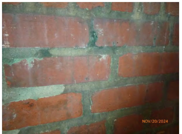
866-143 Brick_Crack Single unit 2024-1.jpg
