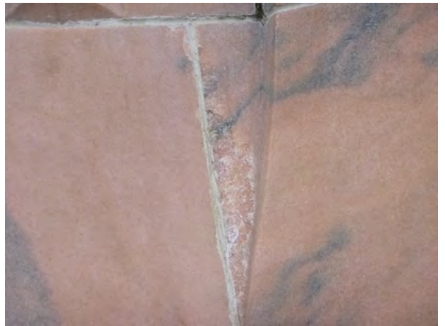
141-185 Stone_SurfLoss Chipped 2024-1.jpg
