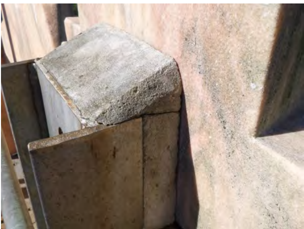
536-197 Concrete_Crack Single unit 2024-2.jpg
