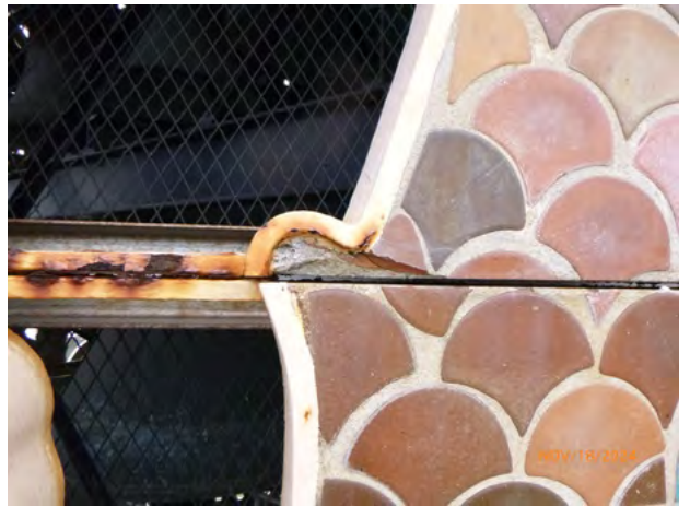
385-159 TerraCotta_Spall Missing 2024-1.jpg
