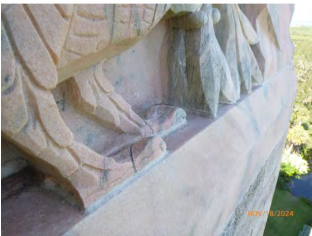
361-138 Stone_Crack Single unit 2024-2.jpg
