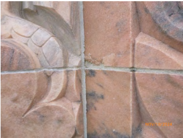
345-194 Stone_SurfLoss Chipped 2024-2.jpg
