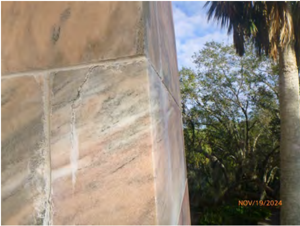
356-37 Stone_SurfLoss Chipped 2024-2.jpg
