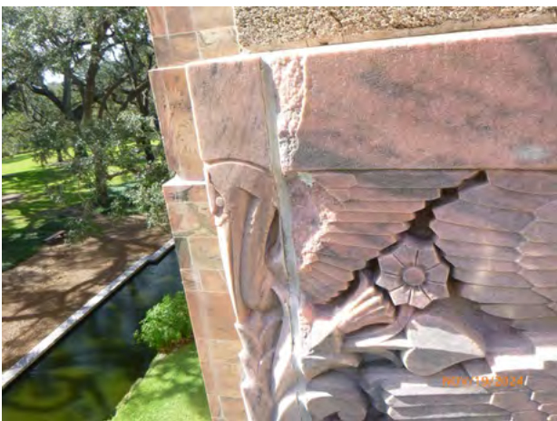
335-30 Stone_SurfLoss Chipped 2024-2.jpg
