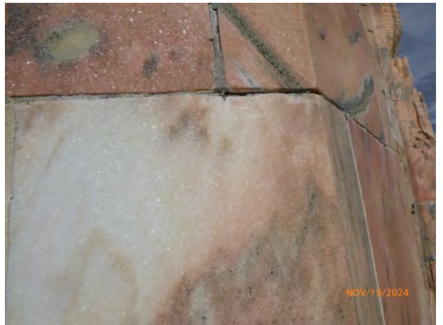
243-190 Stone_SurfLoss Chipped 2024-2.jpg
