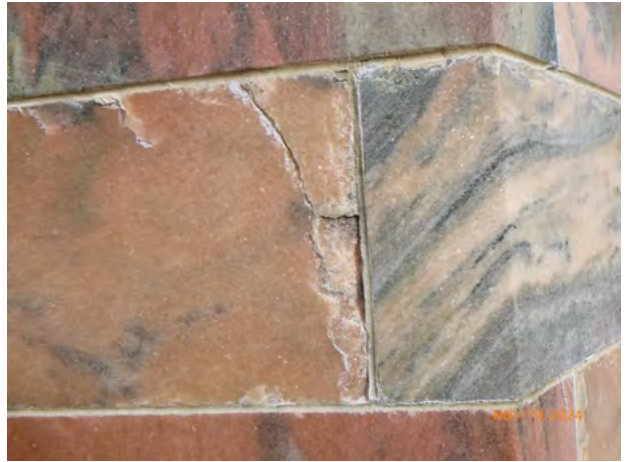
241-181 Stone_Crack Single unit 2024-2.jpg
