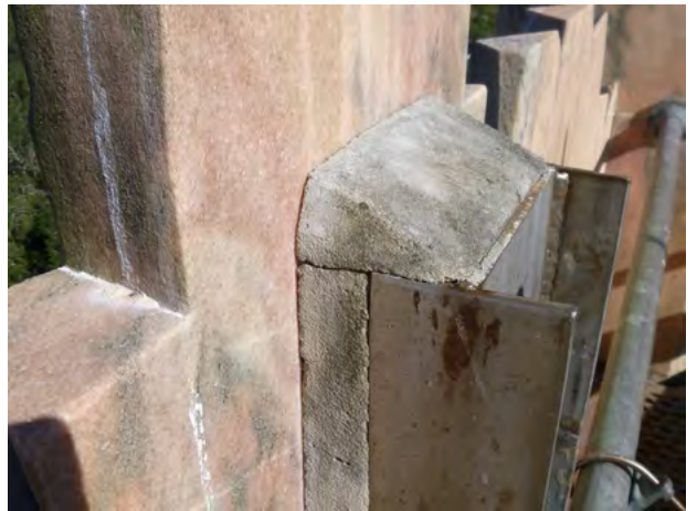
536-197 Concrete_Crack Single unit 2024-1.jpg
