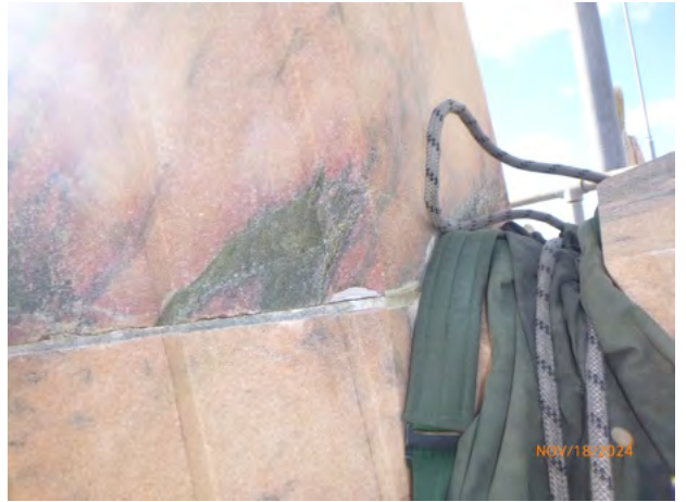
35-195 Stone_SurfLoss Chipped 2024-2.jpg
