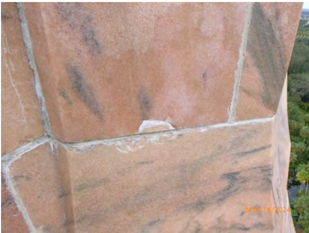
356-185 Stone_SurfLoss Chipped 2024-2.jpg
