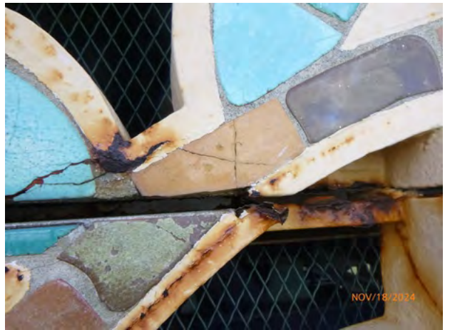
11-173 TerraCotta_Crack Single unit 2024-1.jpg
