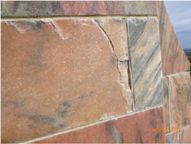
241-181 Stone_Crack Single unit 2024-1.jpg
