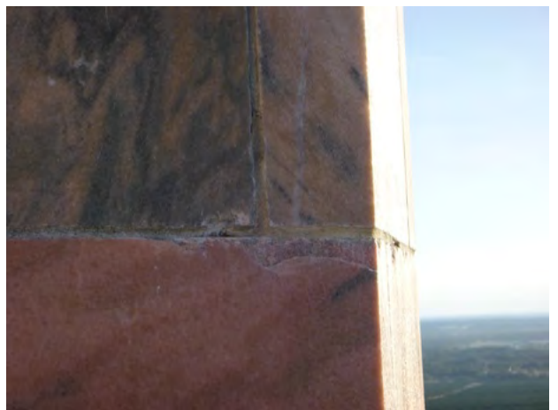
257-189 Stone_SurfLoss Chipped 2024-1.jpg
