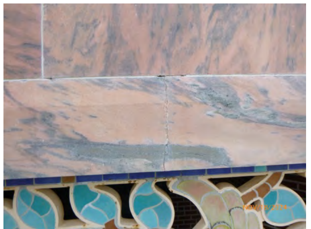
351-138 Stone_Crack Single unit 2024-2.jpg
