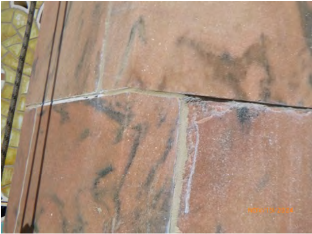
342-158 Stone_SurfLoss Chipped 2024-3.jpg
