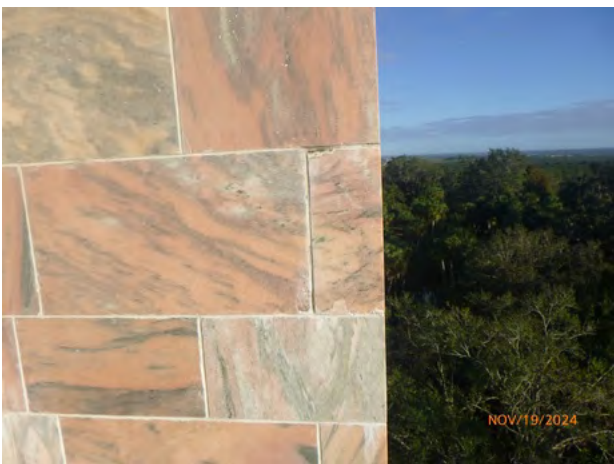
355-72 Stone_SurfLoss Chipped 2024-1.jpg
