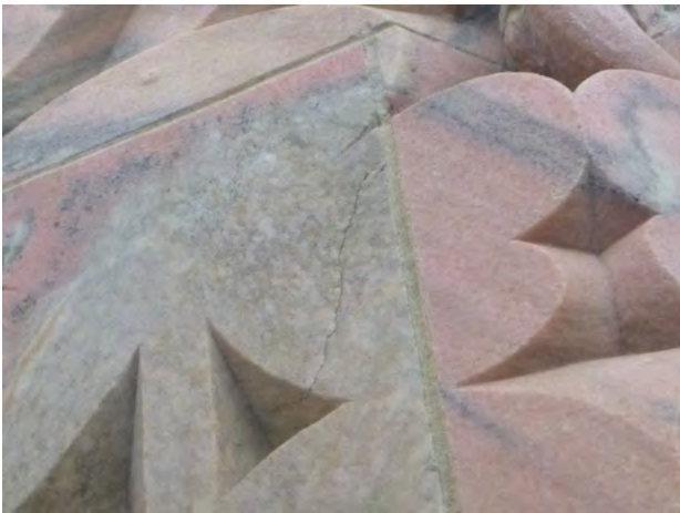
142-192 Stone_Crack Single unit 2024-1.jpg
