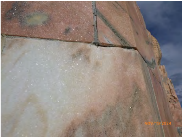
243-190 Stone_SurfLoss Chipped 2024-1.jpg
