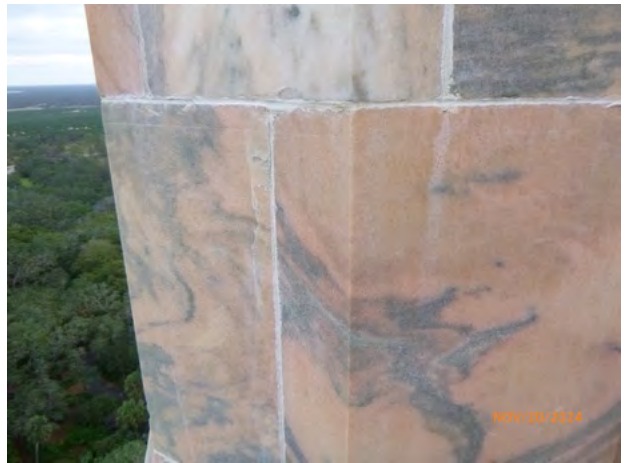
134-187 Stone_SurfLoss Chipped 2024-1.jpg
