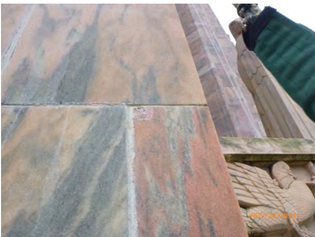
59-142 Stone_SurfLoss Chipped 2024-2.jpg
