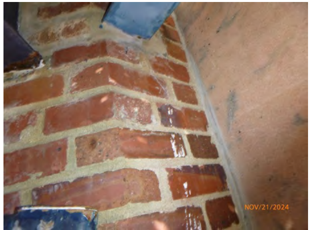
847-190 Brick_SurfLoss Face spalled 2024-1.jpg
