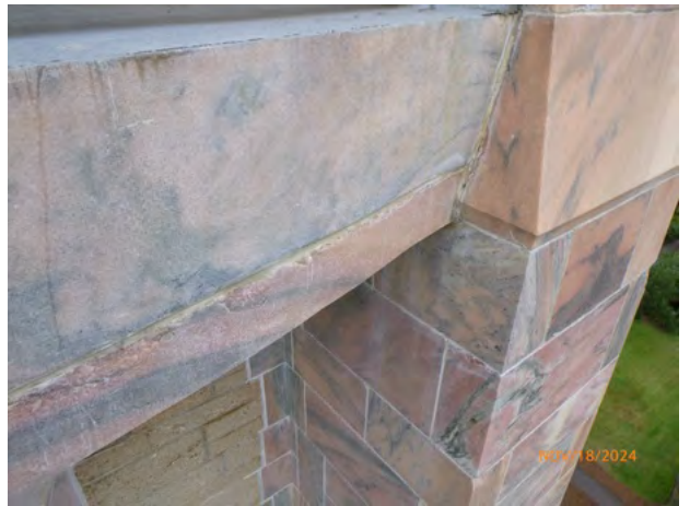
351-122 Stone_SurfLoss Chipped 2024-4.jpg
