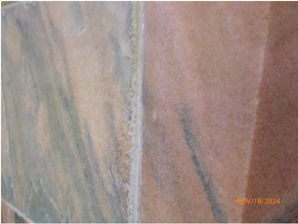
33-180 Stone_SurfLoss Chipped 2024-2.jpg
