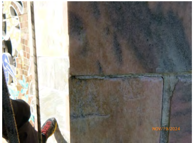
342-151 Stone_Spall Missing 2024-2.jpg
