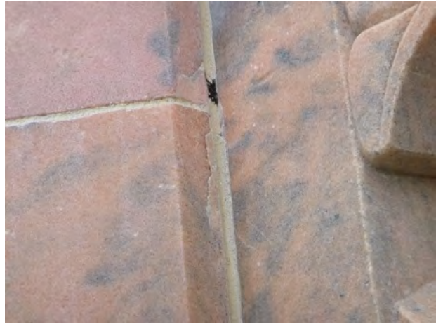
45-191 Stone_SurfLoss Chipped 2024-1.jpg
