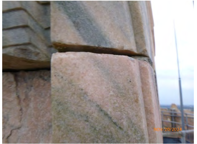
136-200 Stone_Joints Mortar Missing 2024-1.jpg
