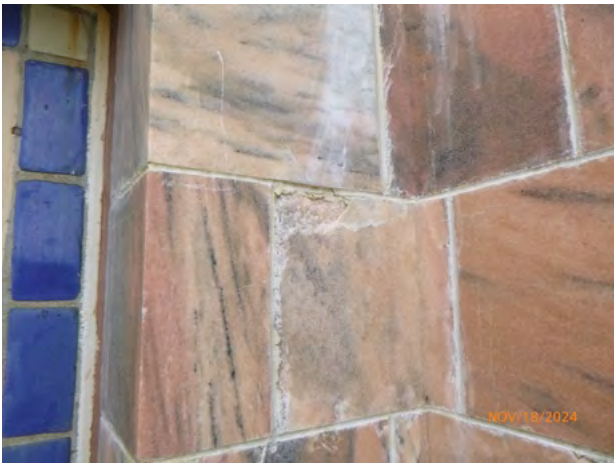
356-137 Stone_SurfLoss Chipped 2024-1.jpg
