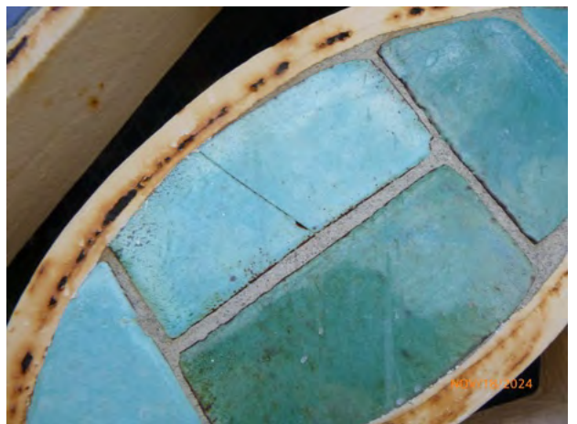
10-175 TerraCotta_Crack Single unit 2024-1.jpg
