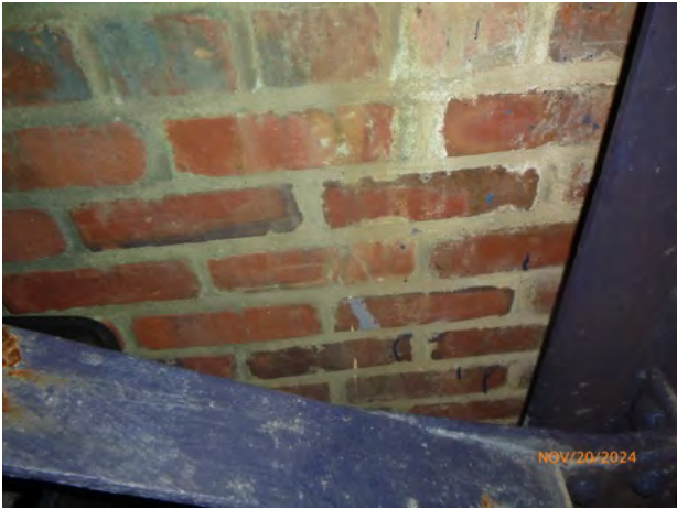
857-139 Brick_Crack Single unit 2024-2.jpg
