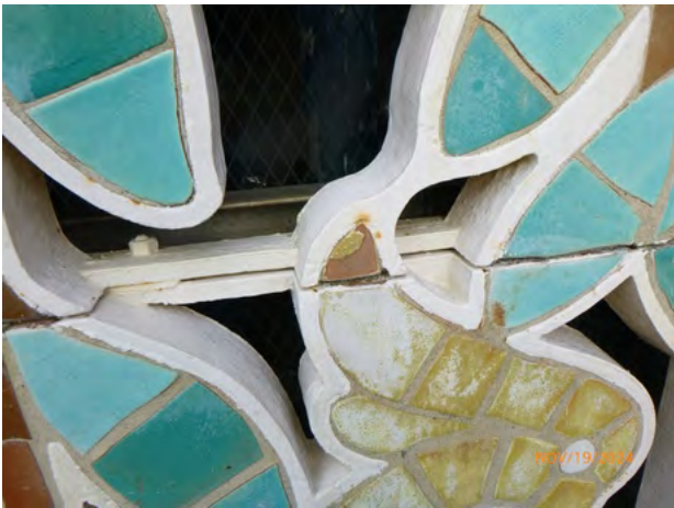
216-163 TerraCotta_SurfLoss Glaze loss 2024-1.jpg
