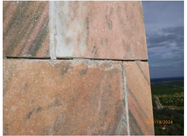
242-188 Stone_SurfLoss Chipped 2024-1.jpg
