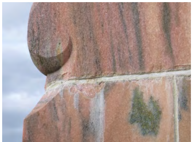
230-158 Stone_SurfLoss Chipped 2024-1.jpg
