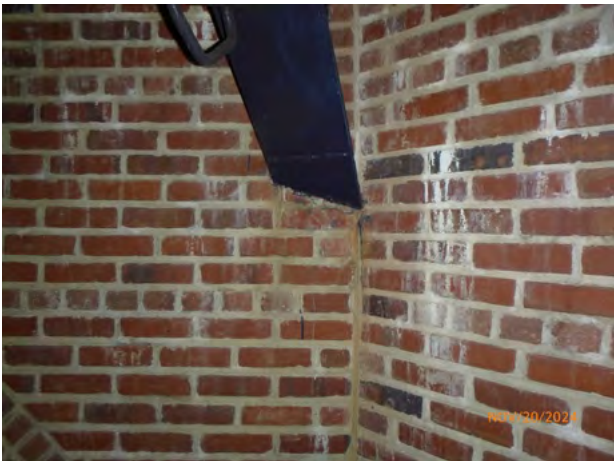
642-179 Brick_Spall Bonded 2024-1.jpg
