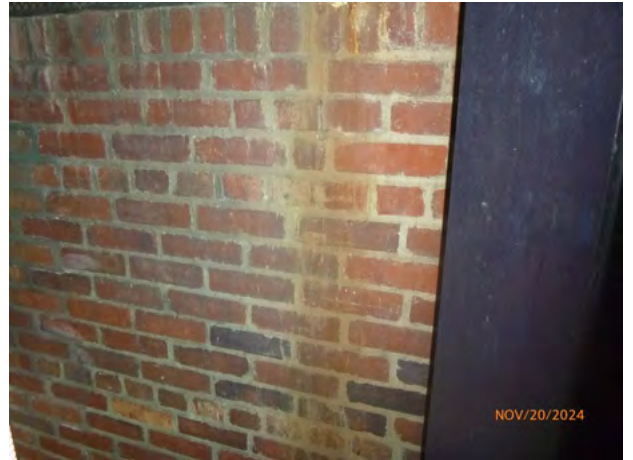
642-140 Brick_SoilStain Rust 2024-2.jpg
