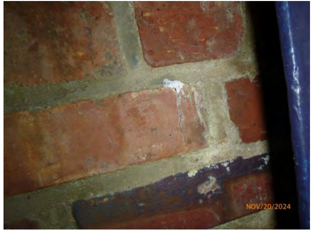
553-140 Brick_Crack Single unit 2024-1.jpg
