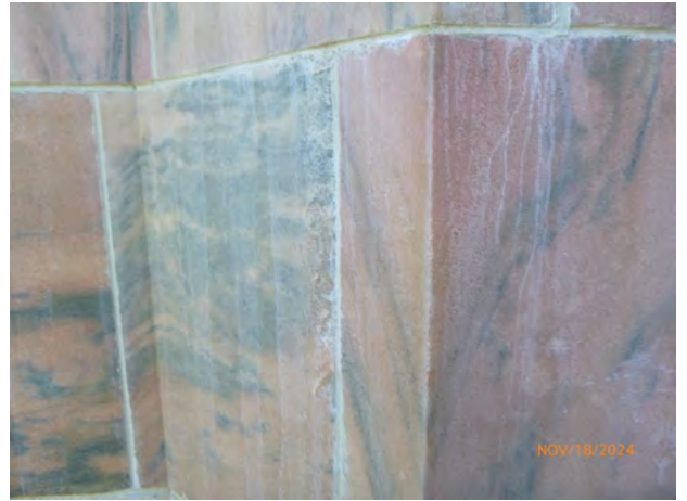
33-142 Stone_SurfLoss Chipped 2024-2.jpg
