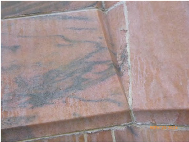
136-184 Stone_SurfLoss Chipped 2024-2.jpg
