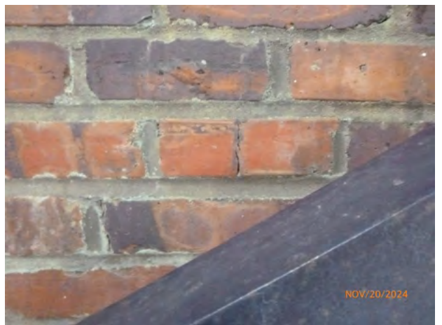
544-142 Brick_Crack Single unit 2024-2.jpg
