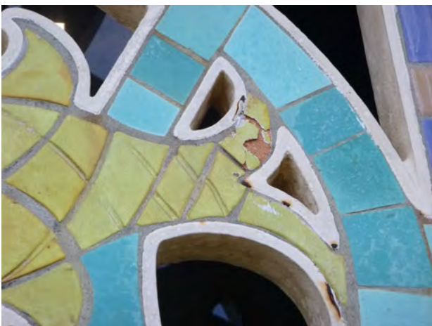
88-111 TerraCotta_Spall Missing 2024-1.jpg
