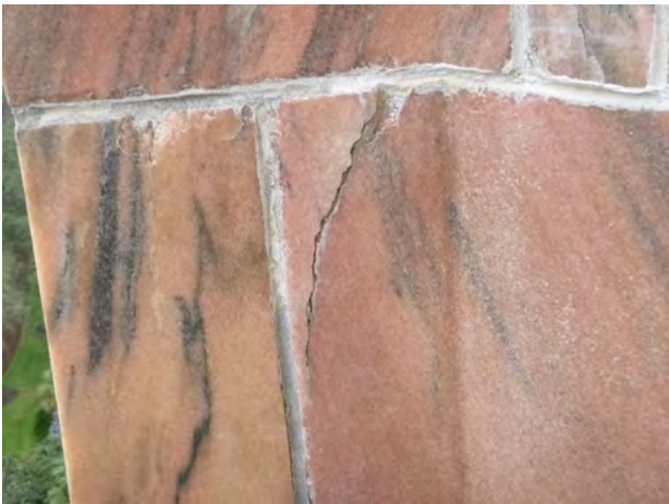
179-178 Stone_Crack Single unit 2024-1.jpg
