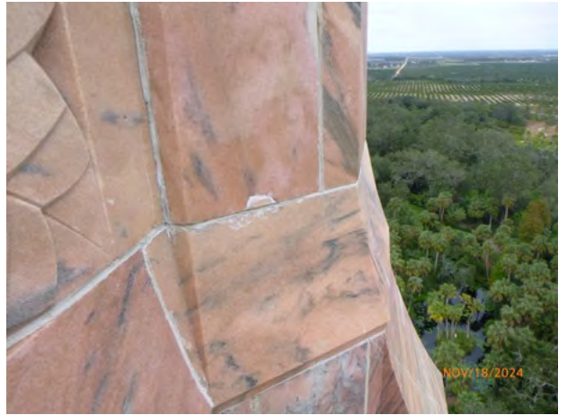
356-185 Stone_SurfLoss Chipped 2024-1.jpg
