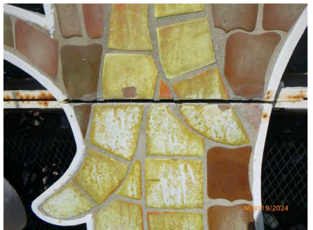
313-164 TerraCotta_SurfLoss Glaze loss 2024-1.jpg
