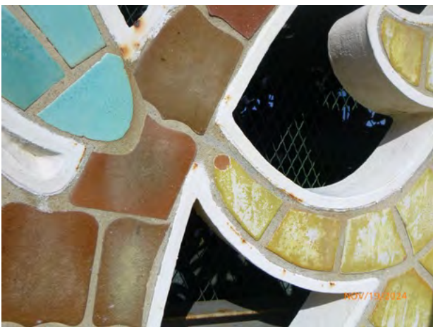
315-160 TerraCotta_SurfLoss Glaze loss 2024-1.jpg
