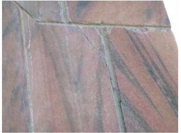
142-173 Stone_Crack Single unit 2024-1.jpg
