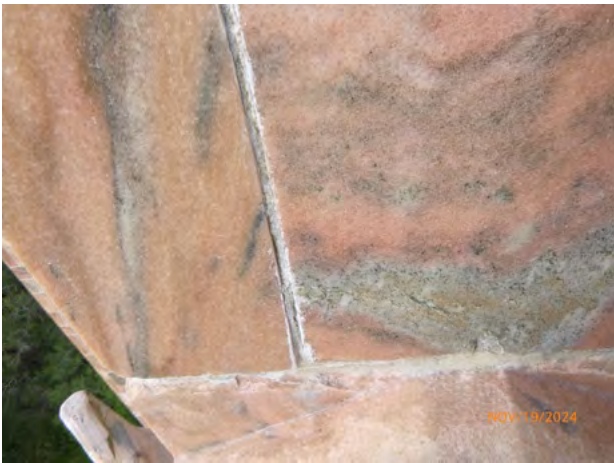
244-163 Stone_SurfLoss Chipped 2024-2.jpg
