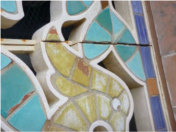
116-161 TerraCotta_SurfLoss Glaze loss 2024-1.jpg
