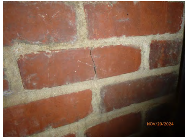
643-143 Brick_Crack Single unit 2024-1.jpg
