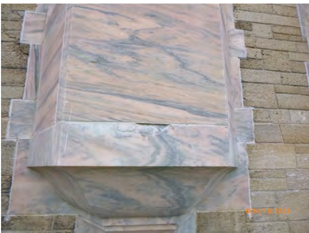
351-102 Stone_SurfLoss Chipped 2024-1.jpg
