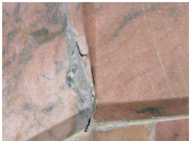
155-183 Stone_SurfLoss Chipped 2024-1.jpg
