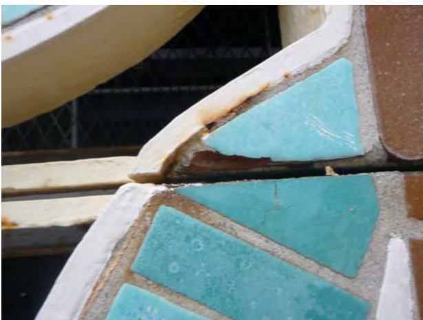
117-169 TerraCotta_SurfLoss Chipped 2024-1.jpg
