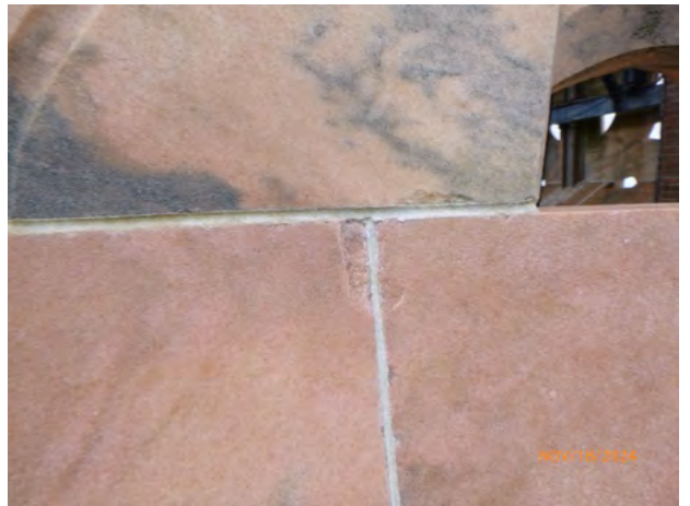
352-184 Stone_SurfLoss Chipped 2024-1.jpg
