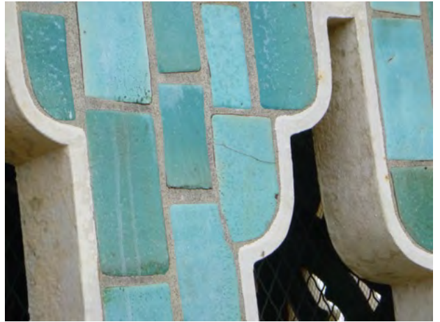
89-174 TerraCotta_Crack Single unit 2024-1.jpg
