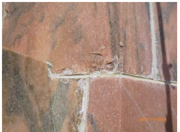
341-141 Stone_SurfLoss Chipped 2024-1.jpg
