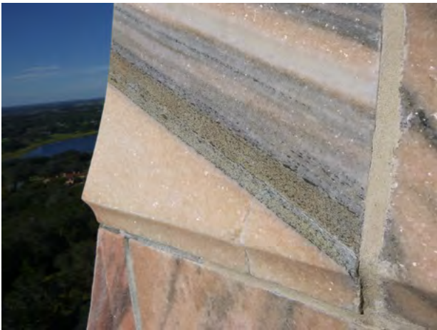
334-183 Stone_Crack Single unit 2024-1.jpg
