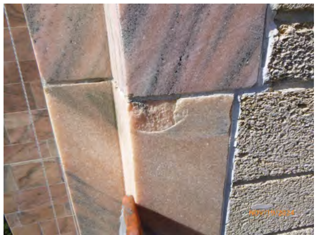
335-105 Stone_SurfLoss Chipped 2024-1.jpg
