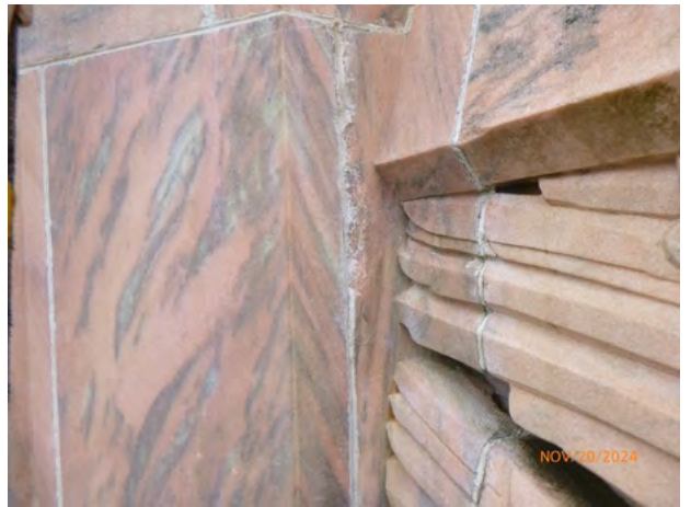
133-139 Stone_SurfLoss Chipped 2024-1.jpg
