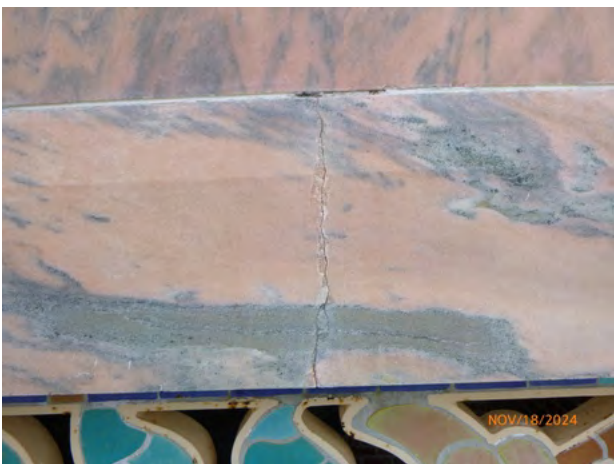
351-138 Stone_Crack Single unit 2024-1.jpg
