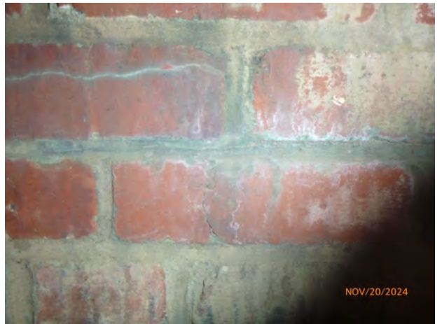
650-142 Brick_Crack Single unit 2024-1.jpg
