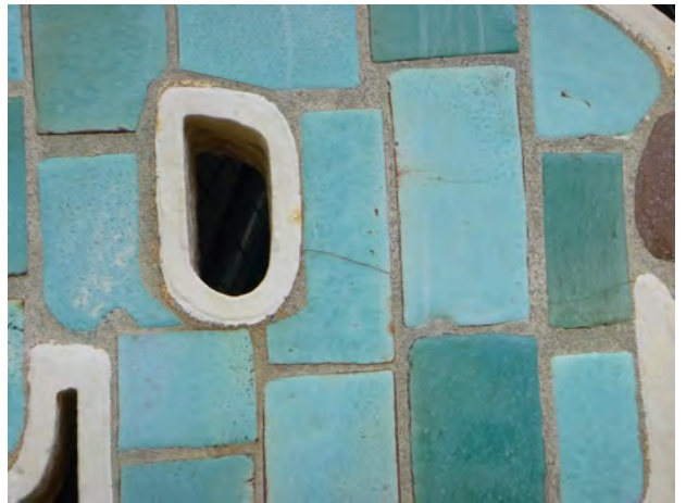
86-175 TerraCotta_Crack Single unit 2024-1.jpg
