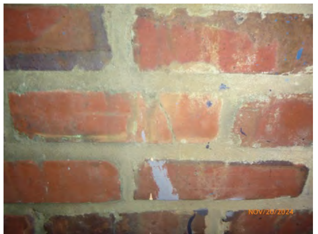
857-139 Brick_Crack Single unit 2024-1.jpg
