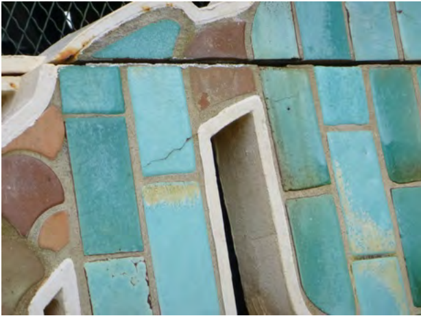
89-157 TerraCotta_Crack Single unit 2024-1.jpg
