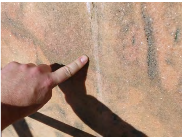
537-195 Stone_Crack Single unit 2024-2.jpg
