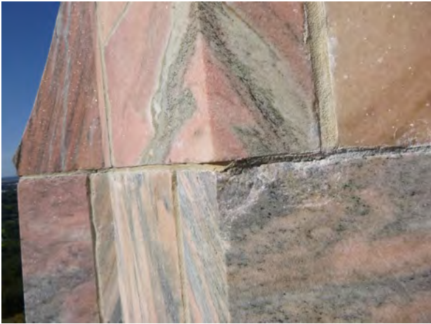
334-182 Stone_SurfLoss Chipped 2024-1.jpg
