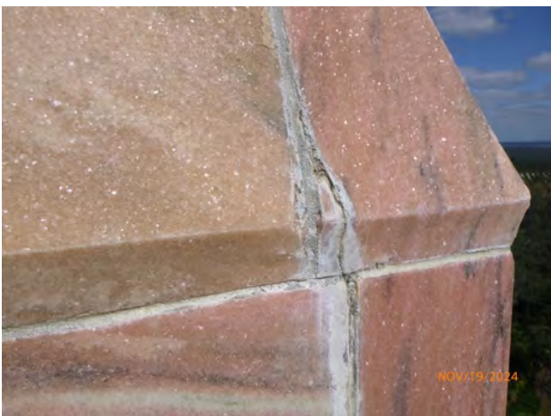
272-121 Stone_Crack Single unit 2024-1.jpg
