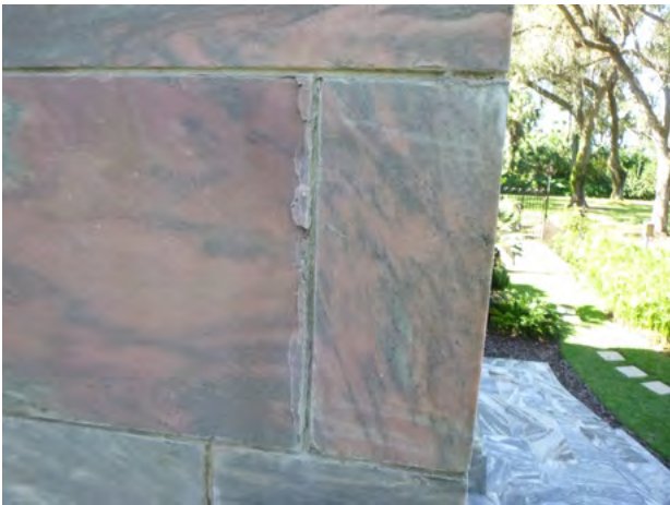
373-11 Stone_SurfLoss Chipped 2024-1.jpg
