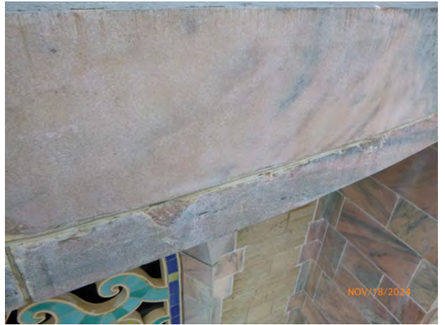
351-122 Stone_SurfLoss Chipped 2024-2.jpg
