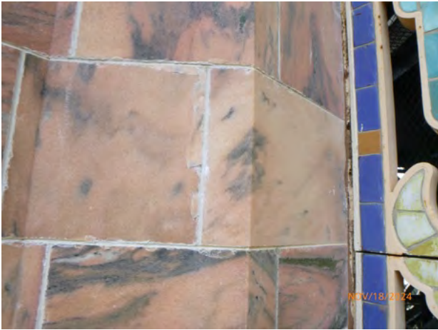
346-160 Stone_SurfLoss Chipped 2024-1.jpg
