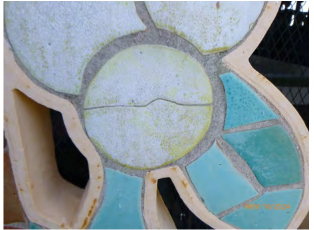
11-160 TerraCotta_Crack Single unit 2024-1.jpg
