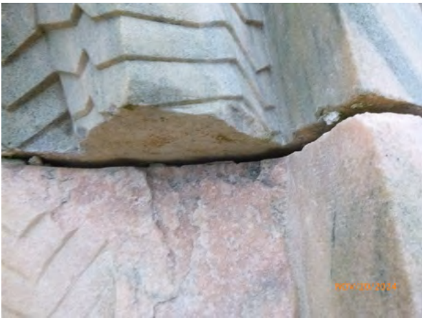
136-200 Stone_Joints Mortar Missing 2024-2.jpg
