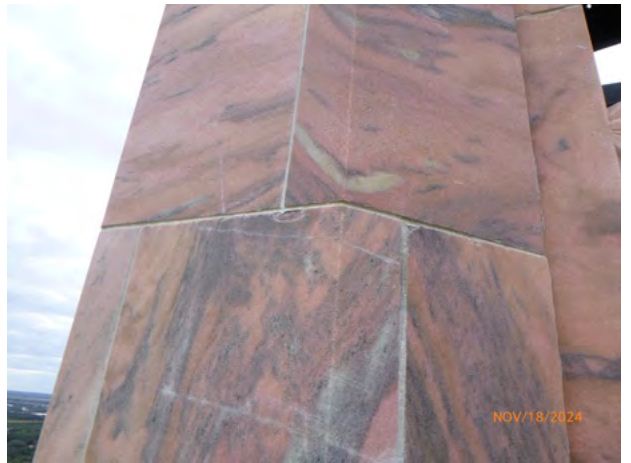
344-186 Stone_SurfLoss Chipped 2024-2.jpg
