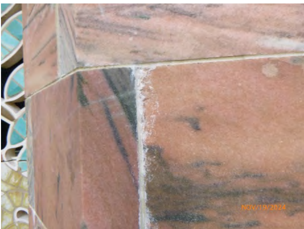
241-164 Stone_SurfLoss Chipped 2024-2.jpg
