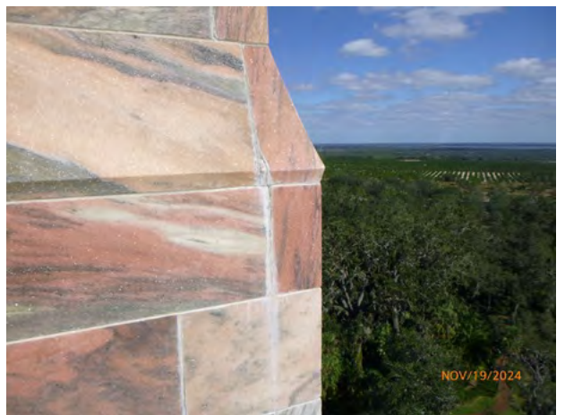
272-121 Stone_Crack Single unit 2024-2.jpg
