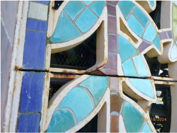
10-154 TerraCotta_Spall Missing 2024-2.jpg
