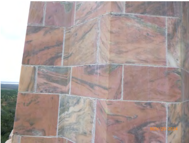
133-161 Stone_SurfLoss Chipped 2024-1.jpg
