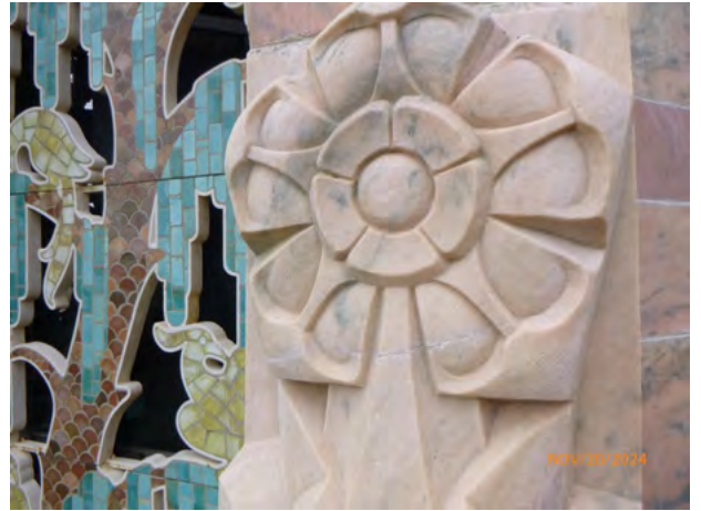
57-161 Stone_Crack Single unit 2024-1.jpg
