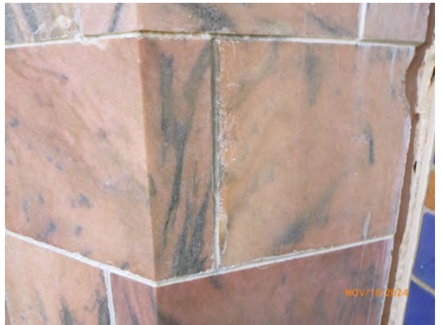
345-171 Stone_SurfLoss Chipped 2024-1.jpg
