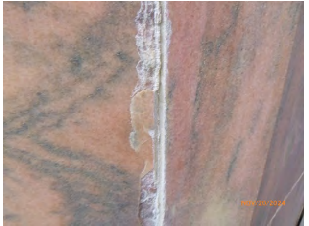
134-146 Stone_SurfLoss Chipped 2024-2.jpg
