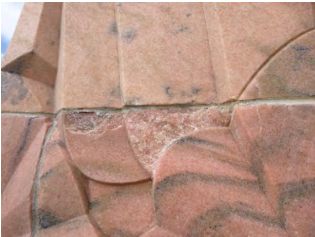
234-192 Stone_SurfLoss Chipped 2024-1.jpg
