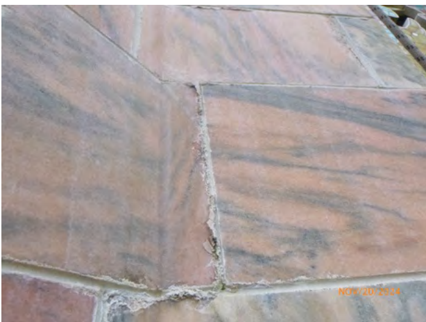
133-148 Stone_SurfLoss Chipped 2024-2.jpg
