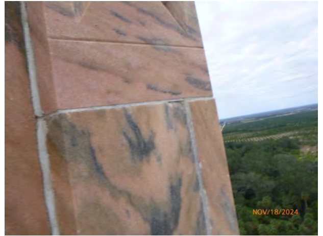
357-191 Stone_SurfLoss Chipped 2024-2.jpg
