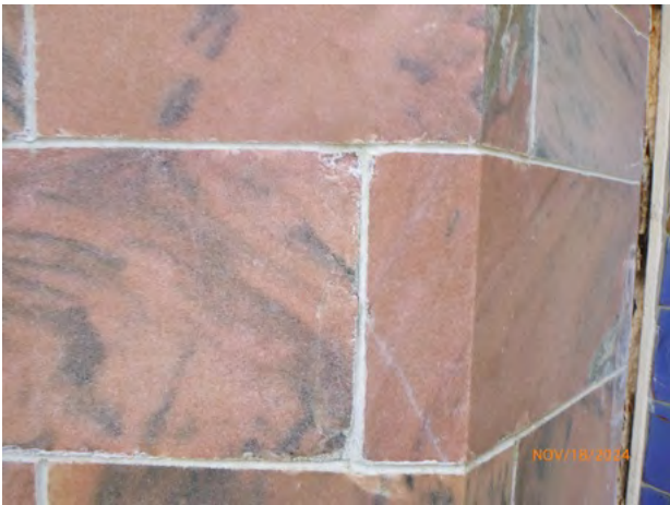
346-162 Stone_SurfLoss Chipped 2024-2.jpg
