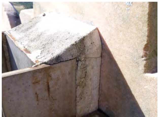
536-197 Concrete_Crack Single unit 2024-3.jpg
