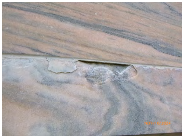
351-102 Stone_SurfLoss Chipped 2024-2.jpg
