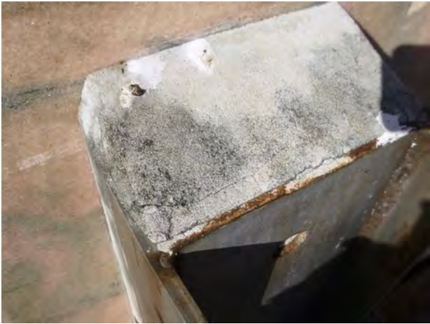
536-197 Concrete_Crack Single unit 2024-4.jpg
