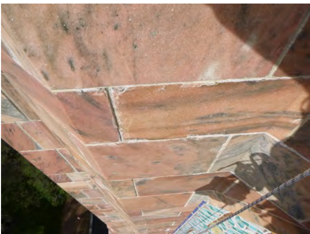
234-180 Stone_SurfLoss Chipped 2024-1.jpg
