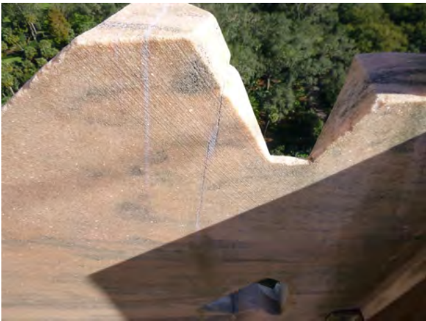
548-195 Stone_Crack Single unit 2024-1.jpg
