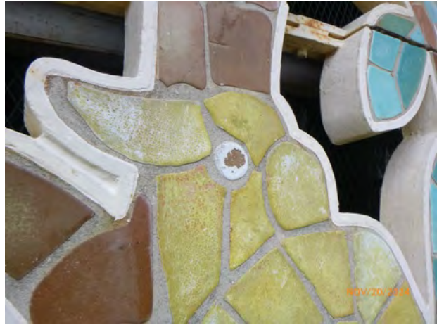
116-171 TerraCotta_SurfLoss Glaze loss 2024-1.jpg
