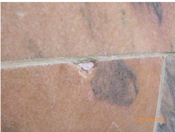
356-187 Stone_SurfLoss Chipped 2024-2.jpg
