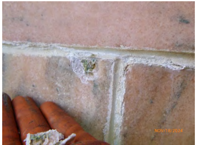
33-176 Stone_SurfLoss Chipped 2024-2.jpg
