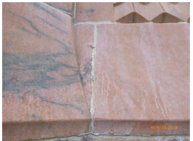
136-184 Stone_SurfLoss Chipped 2024-1.jpg
