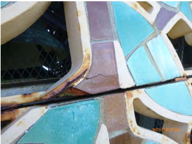
10-155 TerraCotta_Crack Single unit 2024-2.jpg
