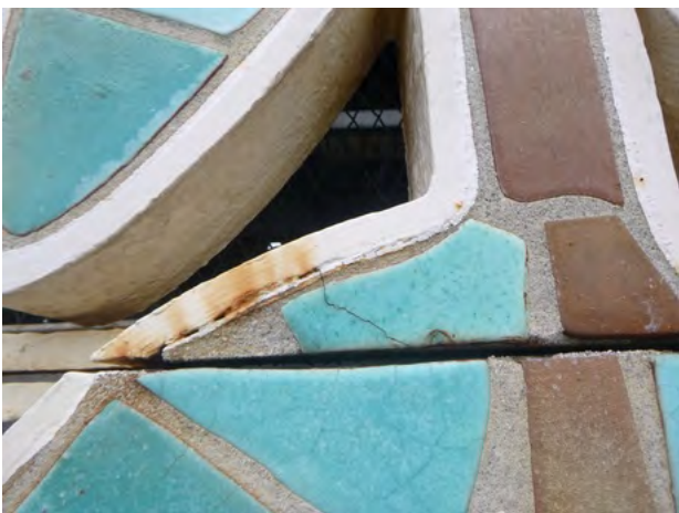
115-164 TerraCotta_Crack Single unit 2024-1.jpg
