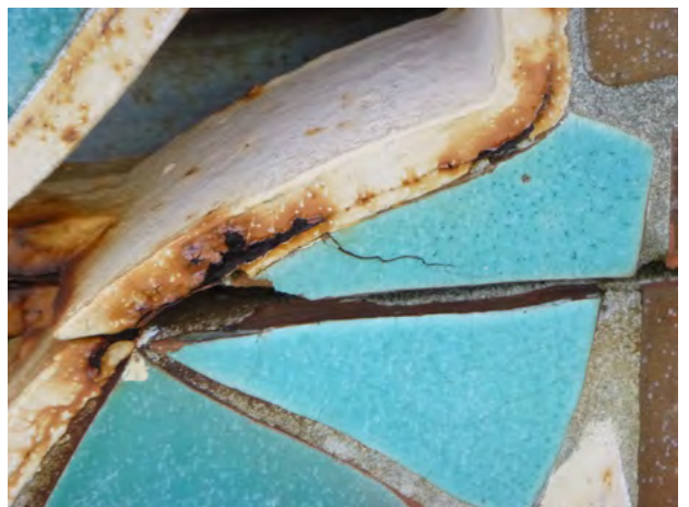
16-164 TerraCotta_Crack Single unit 2024-1.jpg
