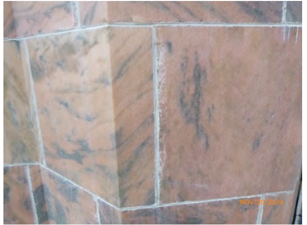
133-159 Stone_SurfLoss Chipped 2024-2.jpg
