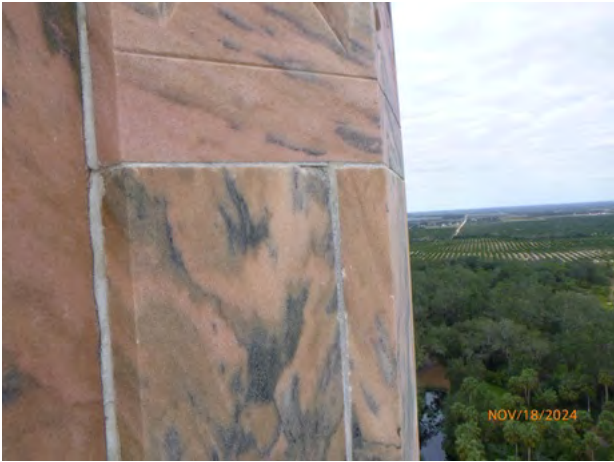
357-191 Stone_SurfLoss Chipped 2024-1.jpg
