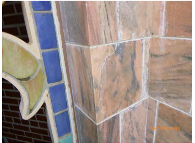
355-135 Stone_Crack Single unit 2024-1.jpg
