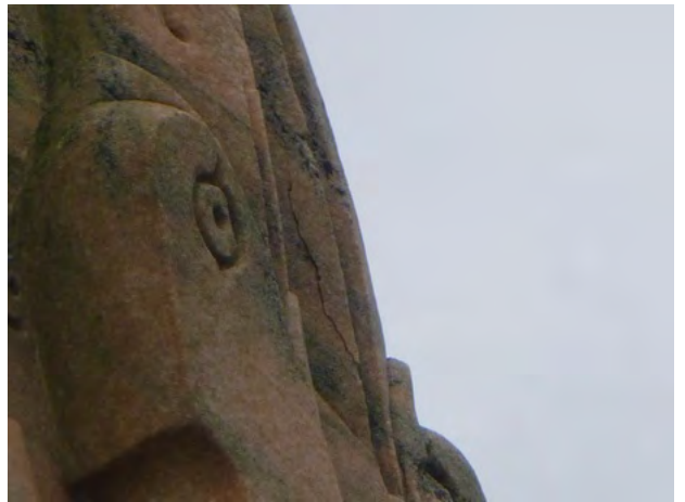
158-193 Stone_Crack Single unit 2024-1.jpg
