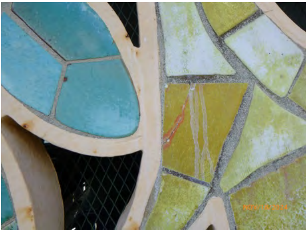
13-175 TerraCotta_Crack Single unit 2024-2.jpg
