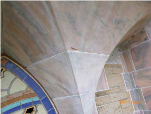
353-119 Stone_SurfLoss Chipped 2024-2.jpg
