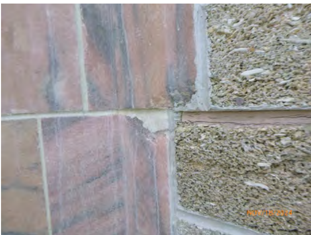
33-80 Stone_SurfLoss Chipped 2024-2.jpg
