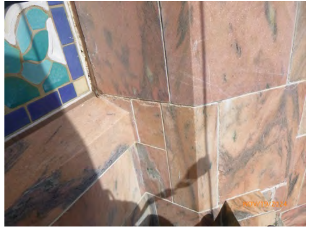
341-143 Stone_SurfLoss Chipped 2024-2.jpg
