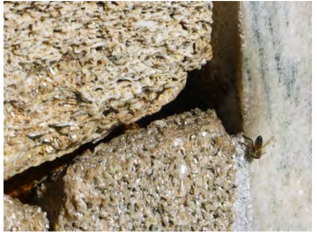
266-92 Stone_Joints Mortar Missing 2024-2.jpg
