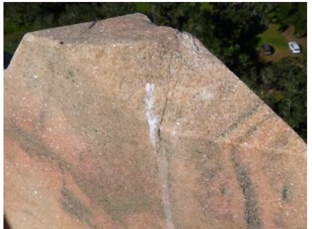
537-195 Stone_Crack Single unit 2024-1.jpg
