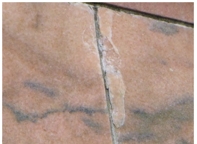
237-182 Stone_SurfLoss Chipped 2024-1.jpg
