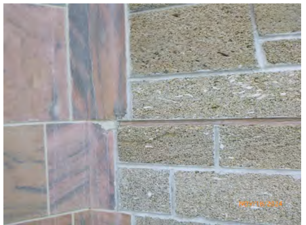
33-80 Stone_SurfLoss Chipped 2024-3.jpg
