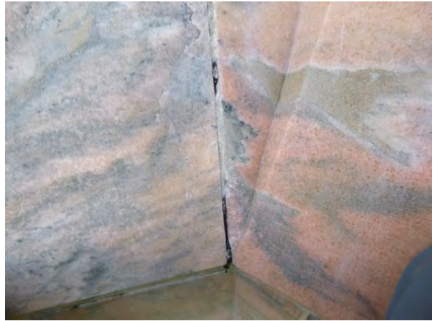
40-183 Stone_SurfLoss Chipped 2024-2.jpg
