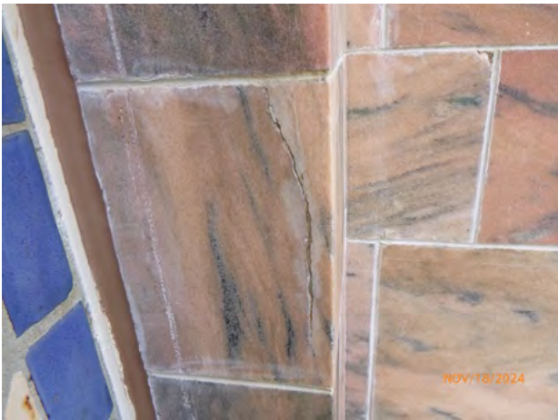
355-135 Stone_Crack Single unit 2024-2.jpg
