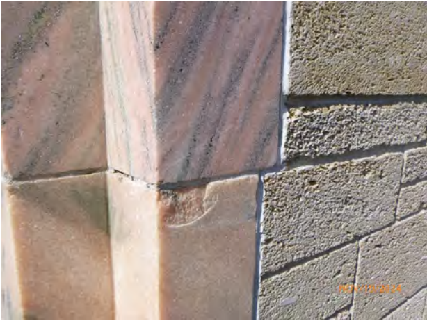
335-105 Stone_SurfLoss Chipped 2024-2.jpg
