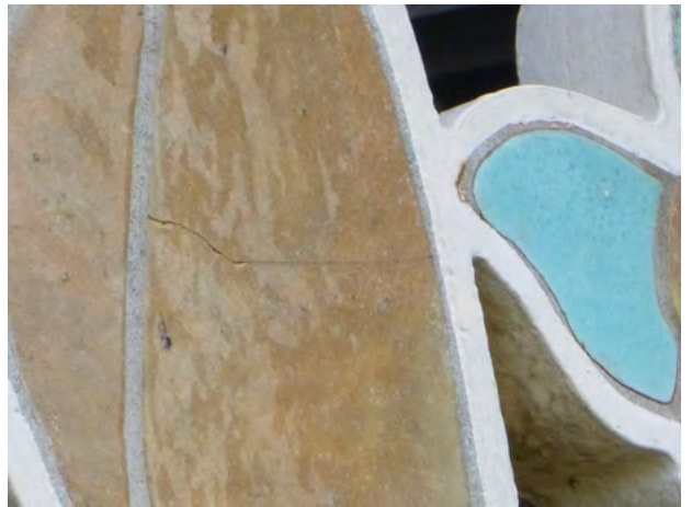
90-133 TerraCotta_Crack Single unit 2024-1.jpg
