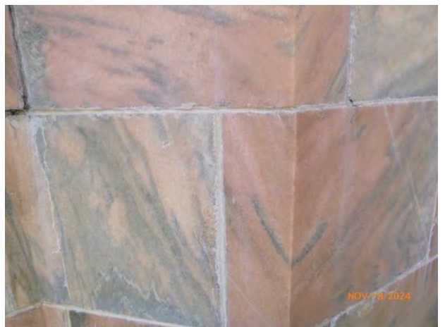
33-180 Stone_SurfLoss Chipped 2024-1.jpg
