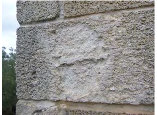
135-45 Stone_SurfLoss Eroded 2024-1.jpg
