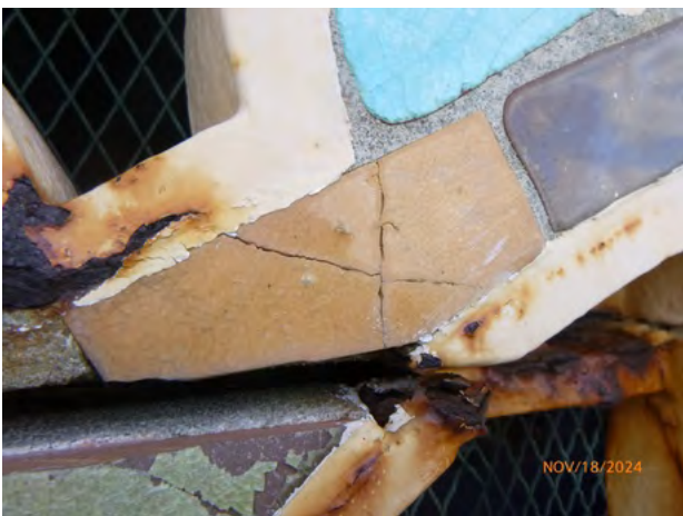
11-173 TerraCotta_Crack Single unit 2024-2.jpg
