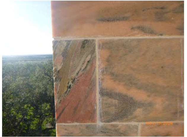
346-78 Stone_SurfLoss Chipped 2024-2.jpg
